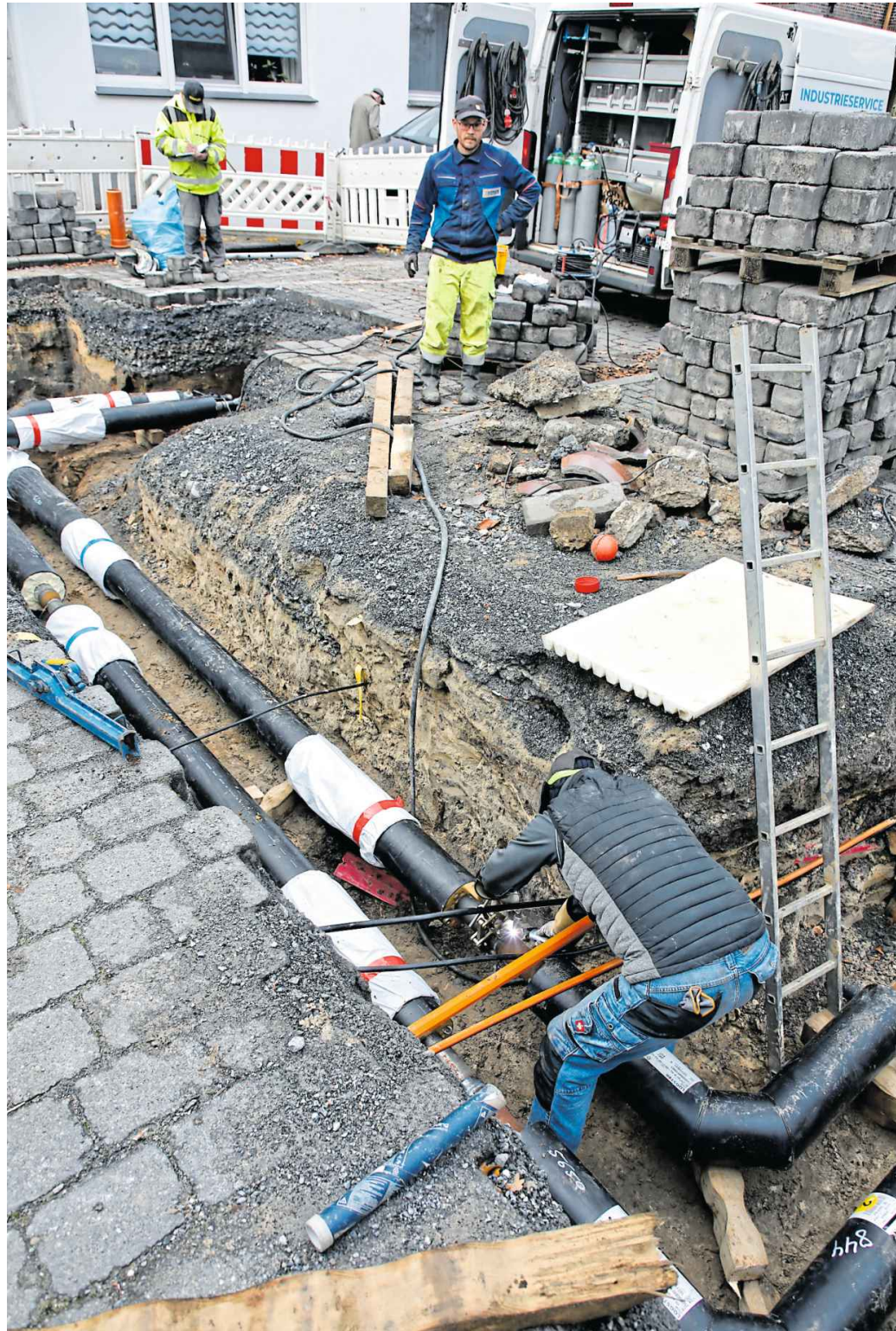
Die Arbeiten zum Ringschluss im innerstädtischen Fernwärmenetz sollen im Bereich der Hauptstraße in etwa zwei Wochen beendet sein. Seit Dienstag ist die Zufahrt zur Baustelle des Hallenbades durch den Kühlmannweg wieder frei.
