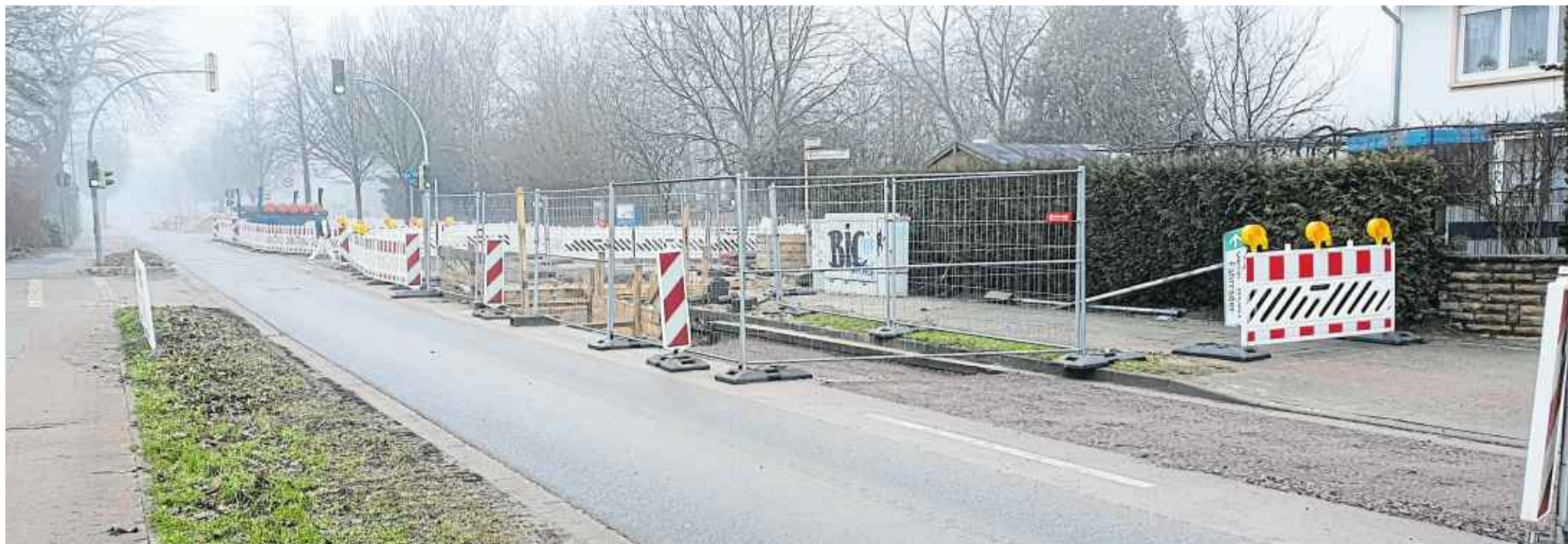
Die Grundstückseinfahrten wurden zunächst mit Schotter verdichtet. Der Grund: Asphalt ist laut Auskunft von Energieservice Westfalen Weser zurzeit nicht verfügbar. MT-Fotos: Sebastian Radermacher
