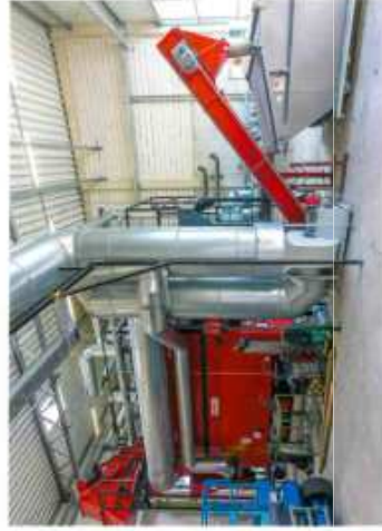
Zu dem 1,7-Megawatt-Kessel im Biomasse-Heizwerk am Freibad der Stadt Verl kam im Jahr 2016 ein 800-Kilowatt-Kessel hinzu. Fotos: Stadt Verl (3)
