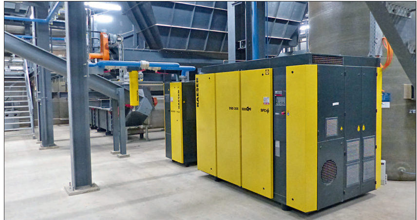
Im Kesselhaus ist auch die neue Druckluftversorgung für den Produktionsbetrieb und die Filterabreinigung des Kraftwerkes untergebracht.
