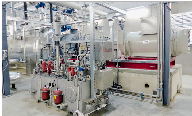
Turboden hat gemeinsam mit Senne speziell für das Projekt eine dreistufige ORC-Anlage entwickelt.
