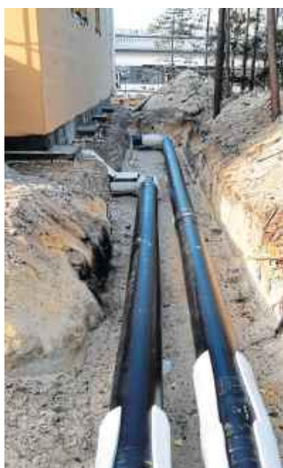
So sehen Nahwärme-Leitungen (hier Staumühle) aus. Foto: WWE
